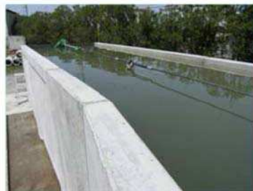
変位後の漏水なし
